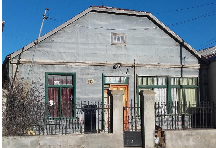
Fig. 27: Cerco en vivienda de Puerto San Julián.
